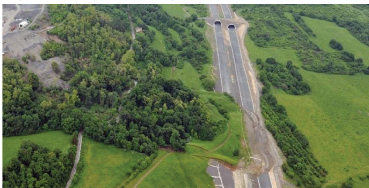
Obr. 1 – Sesuv zeminy v km 56.4
